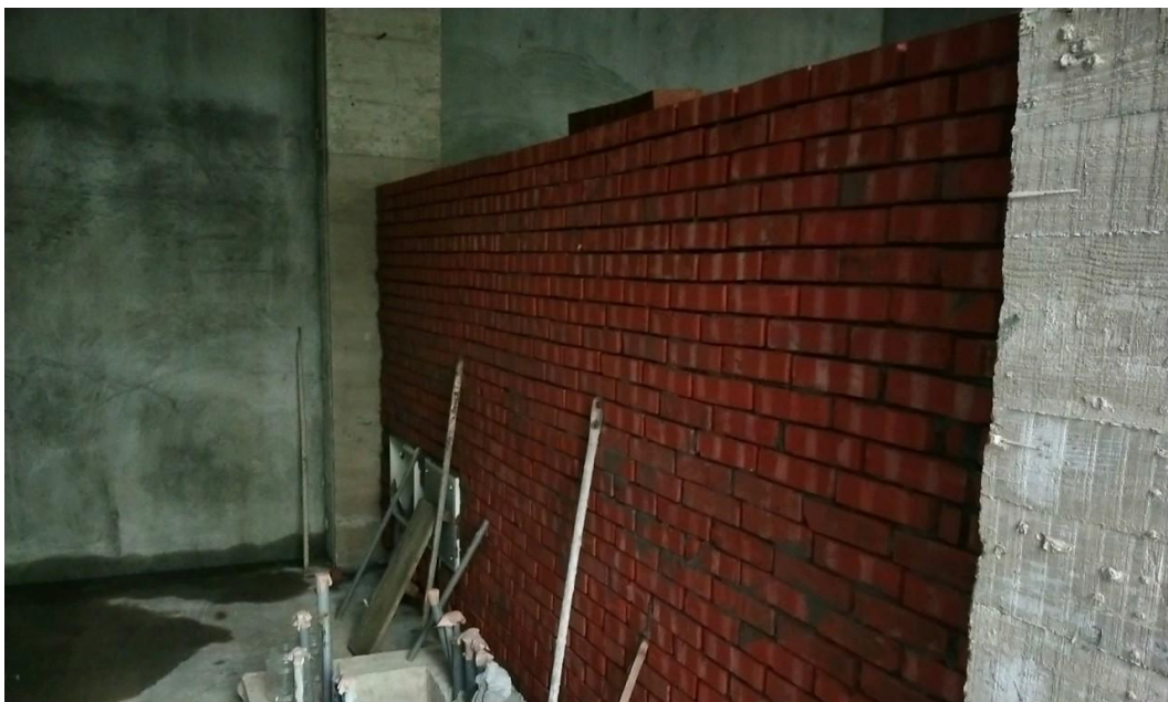
1 樓電氣管路配線
