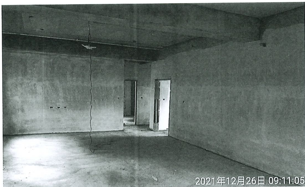
2 樓電氣管路配線
