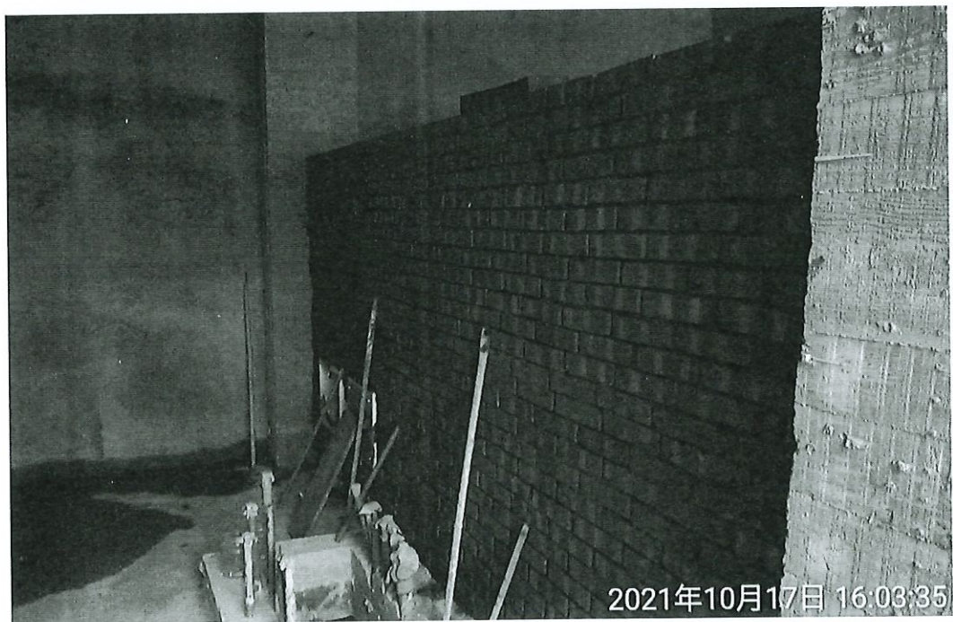
1樓電氣管路配線
