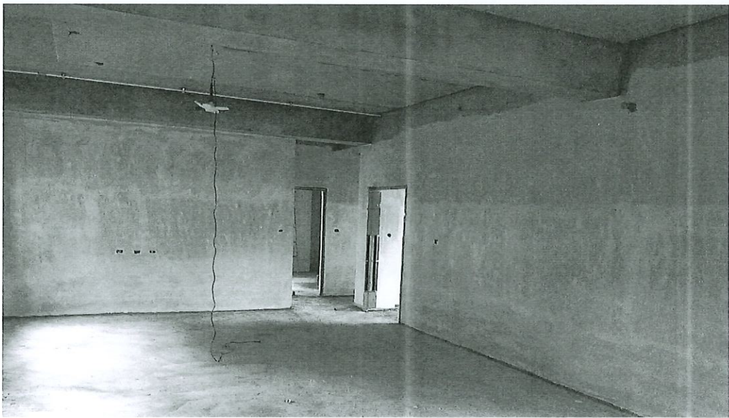
2 樓電氣管路配線
